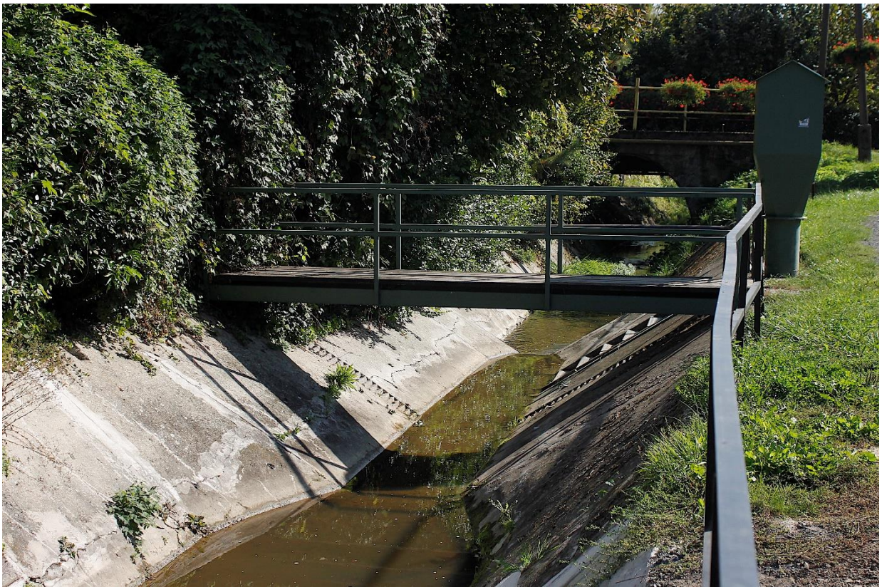
Rézsűburkolattal biztosított monolit vasbeton hordalékfogó műtárgy a Burnót-patakon
